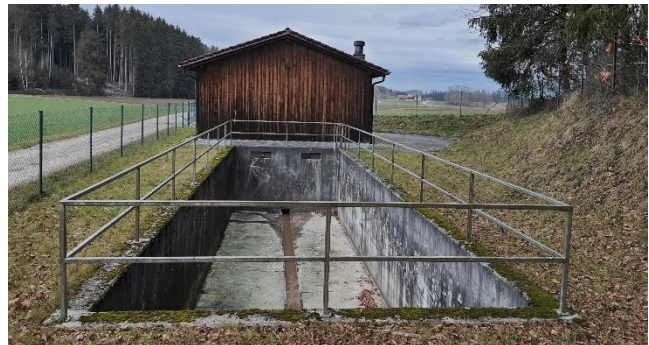
Das Pumpwerk in Geiselfing. – Bild: Gemeinde Palling
