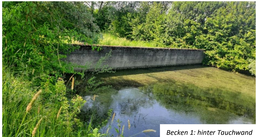
Becken 1: links Zulauf mit Prallwand, rechts Tauchwand
