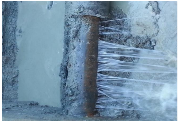
Eine Leckstelle der Hausanschlussleitung. Besonders an den nicht sichtbaren Teilen des Kanalsystems bleiben Schäden oft lange unbemerkt und ziehen größere Folgeschäden nach sich. Foto: tatwort © FWV Franken
