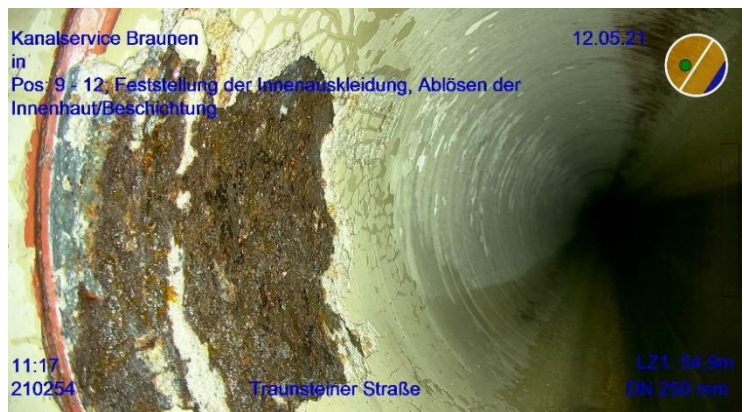
Bild unseres Kanals in der Traunsteiner Str. mit gesammelten Informationen wie Durchmesser (250mm) und Schäden wie das Ablösen der Beschichtung.
